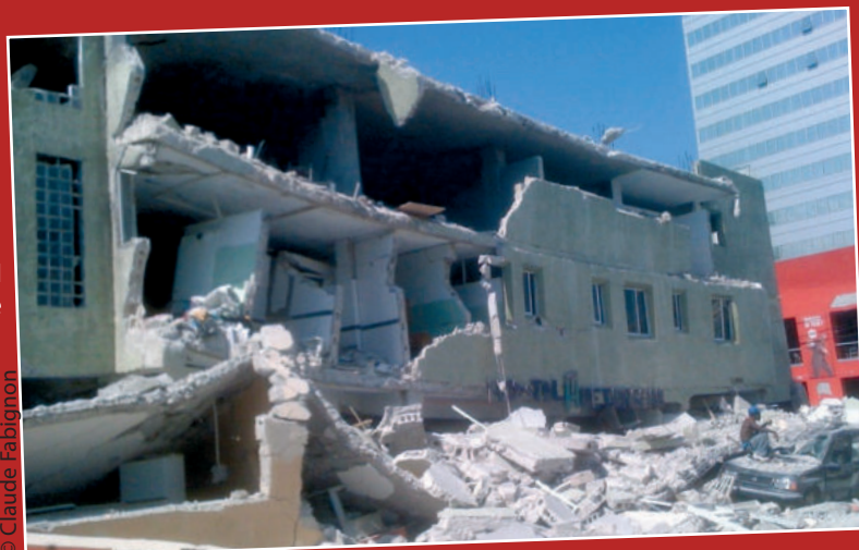
Un hôpital effondré
